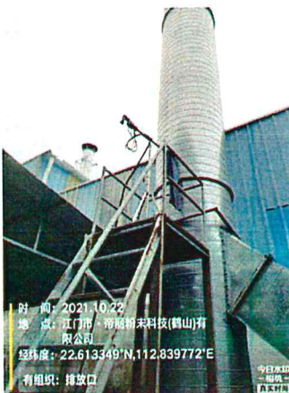
图 3: 有组织废气排放口监测点
